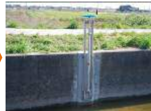
巻き上げ式ゲート
