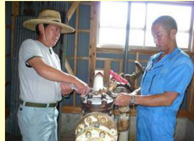
ポンプの点検状況
