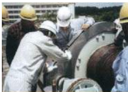
ポンプ点検状況
