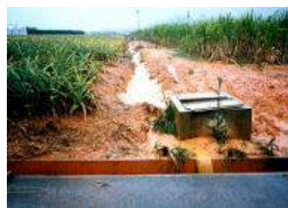
土砂の流出状況
